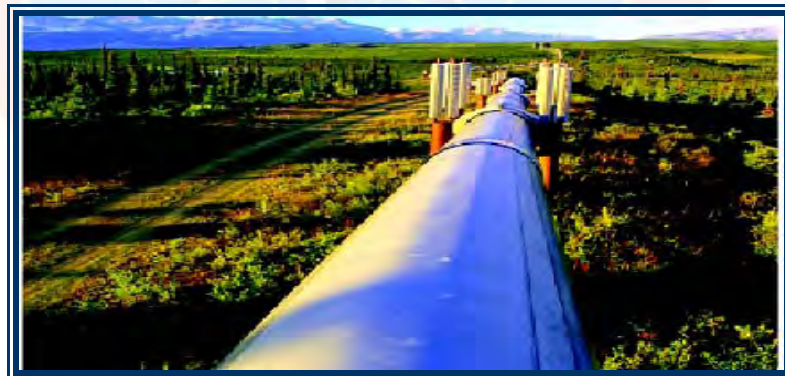
Figura 2.1 Ejemplo de un gasoducto. Fuente:( Pino. Transporte del gas natural)
