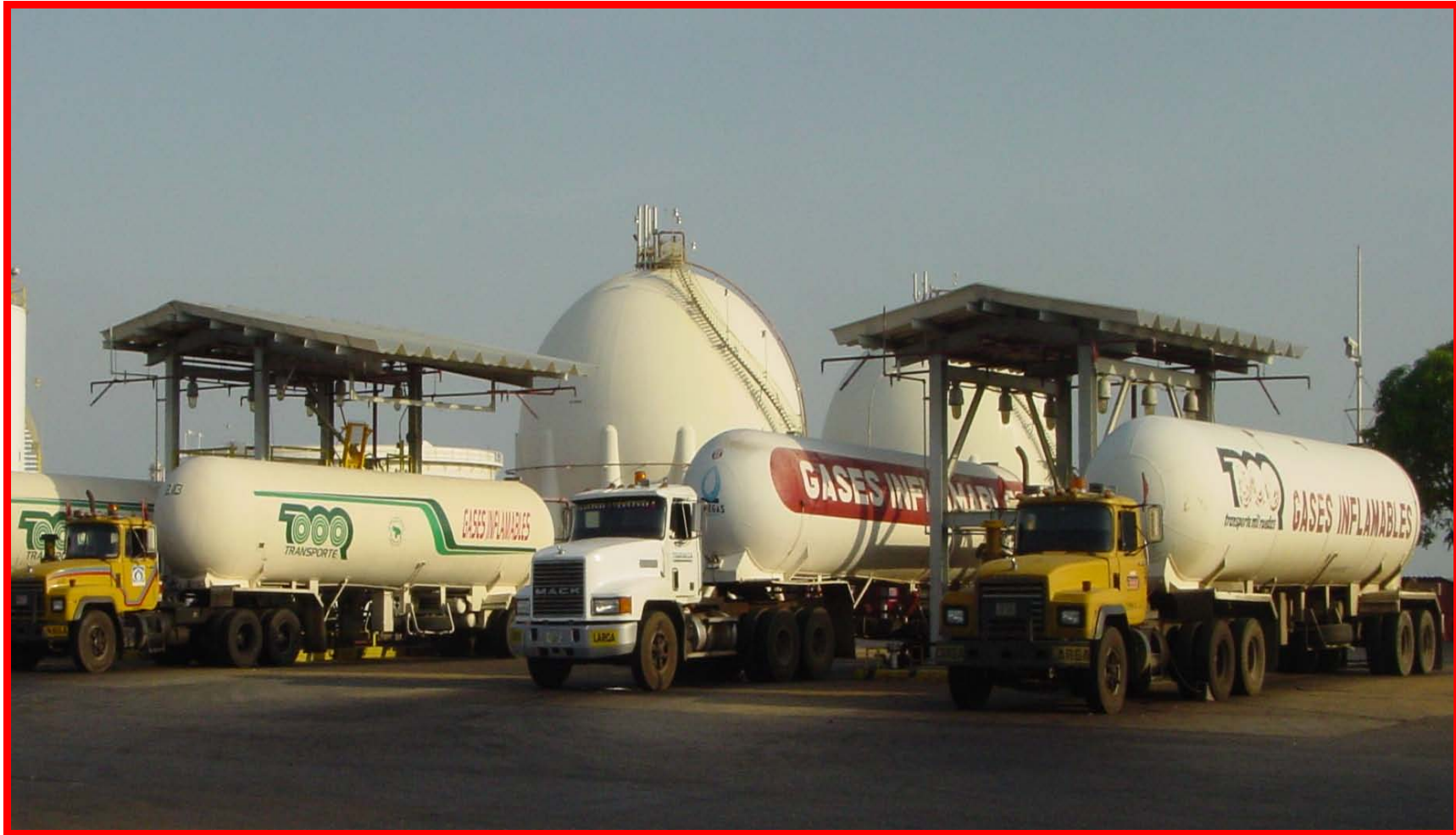
D.1 "Área de llenadero de camiones de la Planta Criogénica Jose Antonio Anzoátegui"
