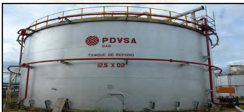
Figura 4.7 Tanque de Reposo Fuente: Servidor PGA, PDVSA Gas. (2010)
