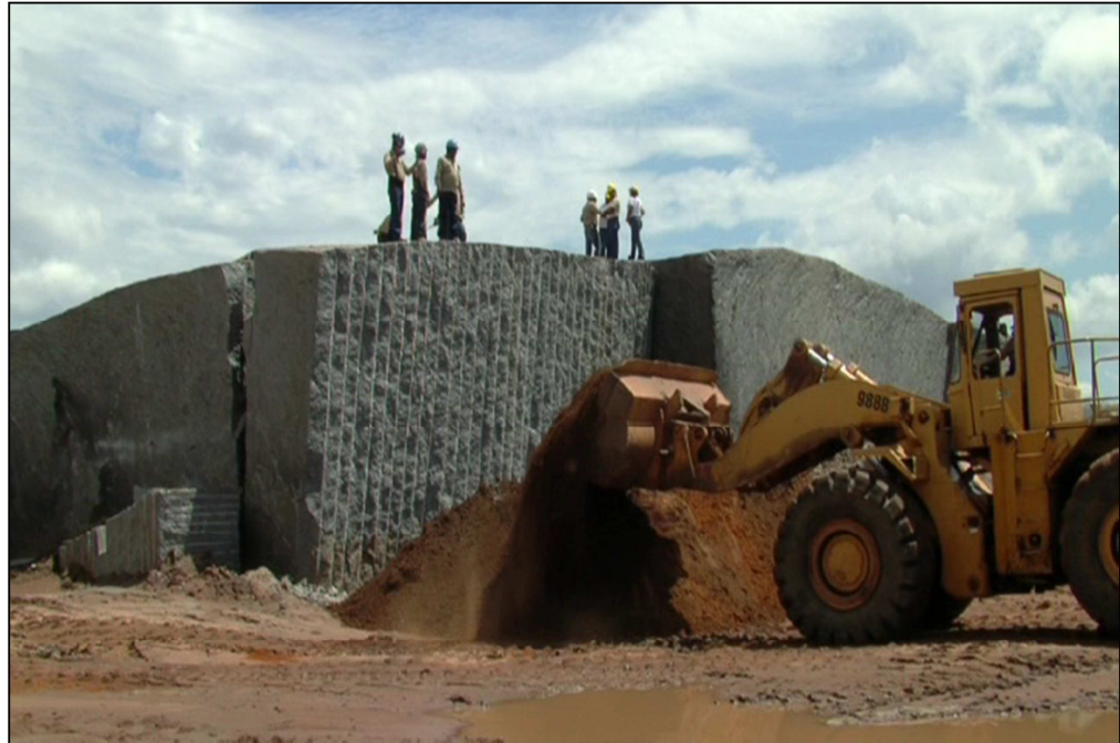
Figura 5.9 Colchón de tierra para amortiguar el impacto de caída del bloque (EXPIGUA, Cantera la Leona 2010)
