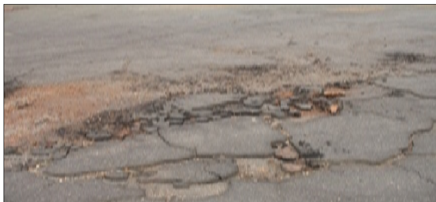
Figura 5.8 Bache en muy mal estado.
