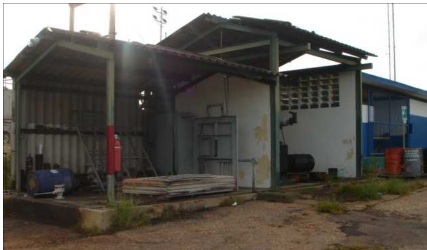
Figura 6.11 Vista de los galpones con asbesto.
