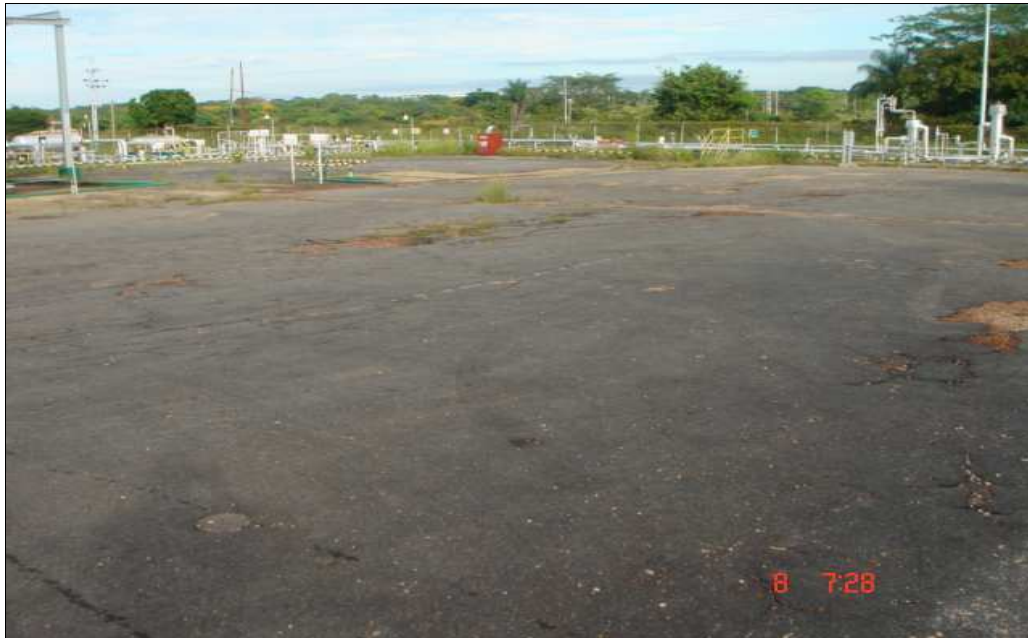
Figura 6.7 Zona con más de 300 m 2 de pavimento dañado.
