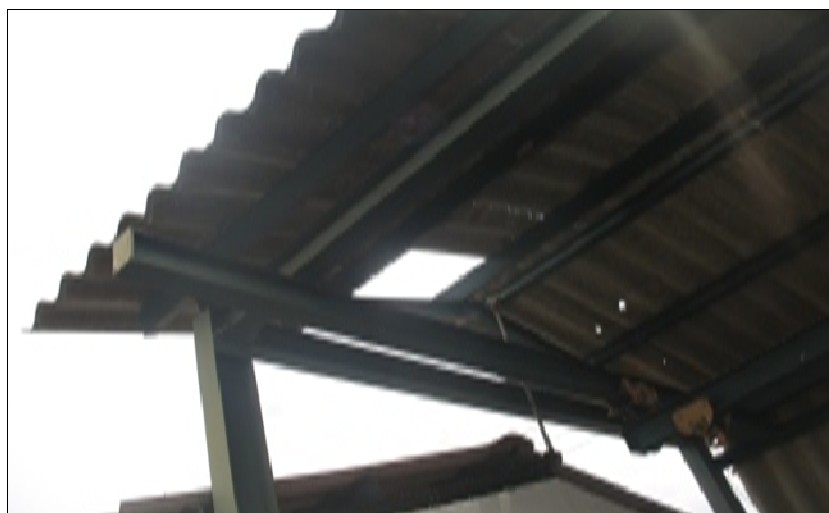
Figura 5.13 Deterioro del asbesto.
