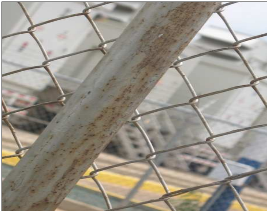
Figura 5.11 Tubo del cerco perimetral oxidado.
