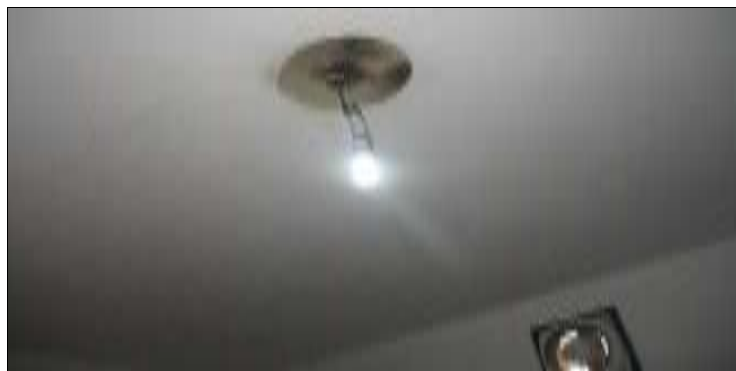
Figura 5.4 Ausencia de lámpara en oficina de operador.
