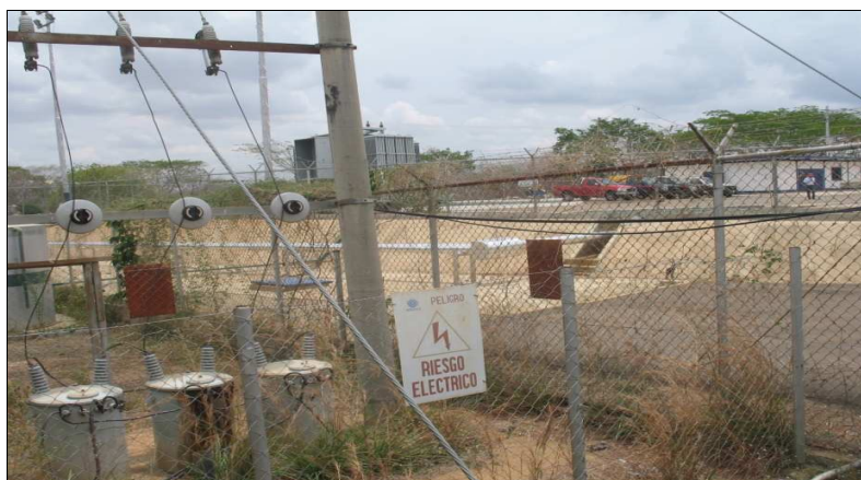
Figura 5.6 Zona de riesgo eléctrico rodeado de maleza.
