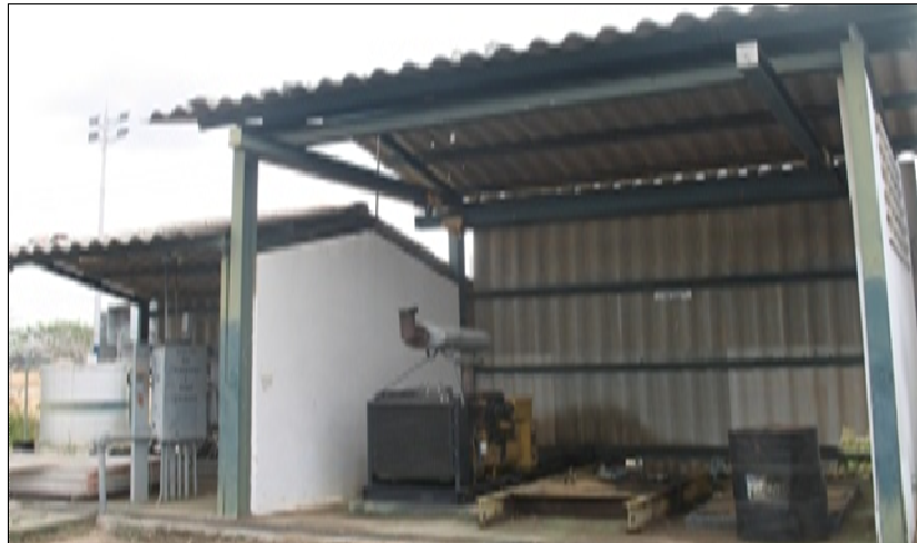
Figura 5.12 Zona de las instalaciones con uso de asbesto.
