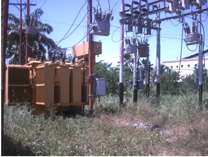
Fig. 2.2 Transformador de 10 MVA (Villas Olímpicas) sobre rolas.
