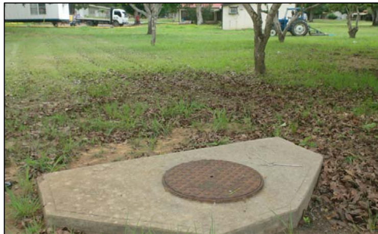
Tanque tipo E con tapa manhole
