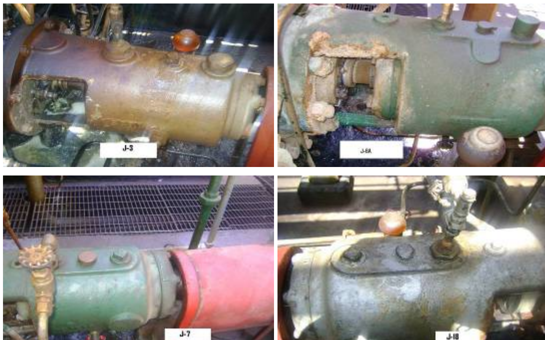
Figura N° 4.27 Bombas J-3, J-6A, J-7 y J-18 de la unidad de FCC
