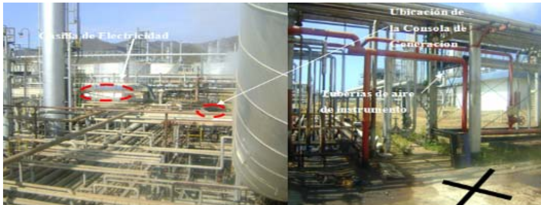
Figura N° 4.11 Foto de ubicación de la consola de generación en planta
