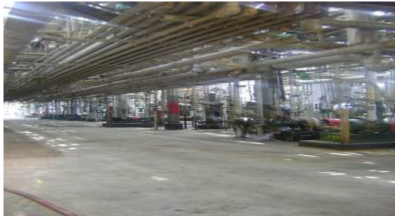
Figura N° 4.13 Pasillo de bombas unidad de FCC
