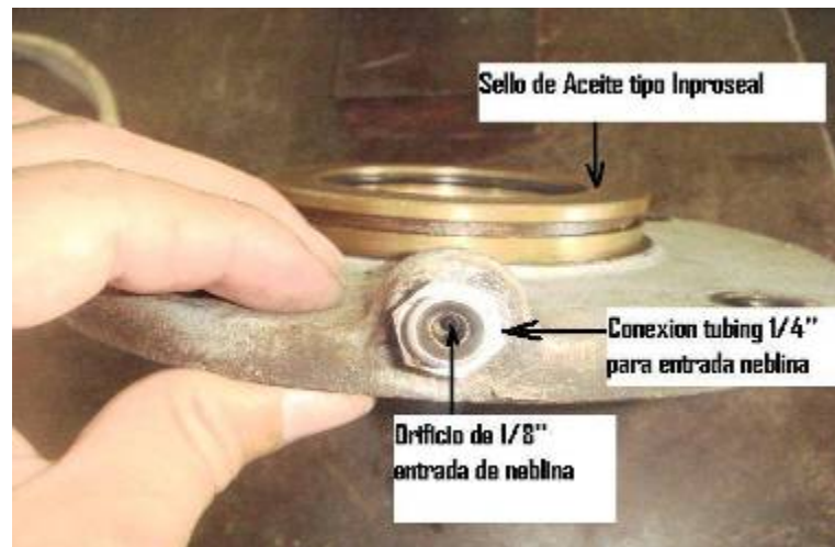
Figura N° 4.31 Conexión de entrada de neblina (Oil Mist) en tapa de la caja de rodamientos de la Bomba G-0302A
