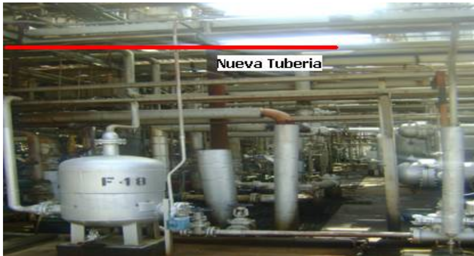
Figura N° 4.16 Pasillo trasero de las bombas J- 99 Hasta J- 14B
