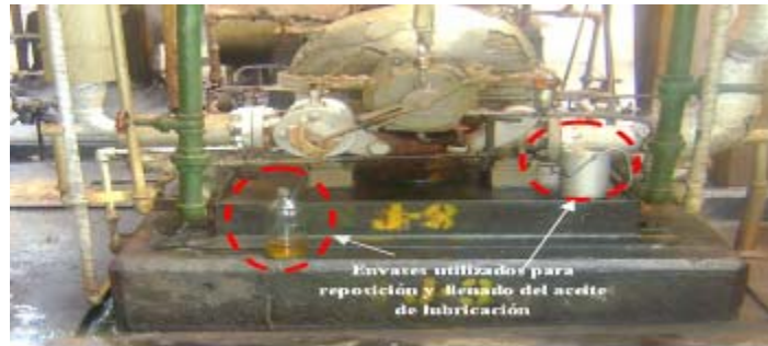
Figura N° 4.4 Causa de Fallas de los rodamientos.
