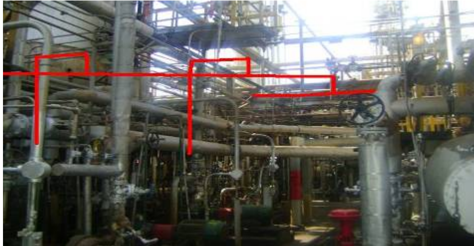
Figura N° 4.15 Pasillo Hacia las bomba J-5, J-53-J-7.
