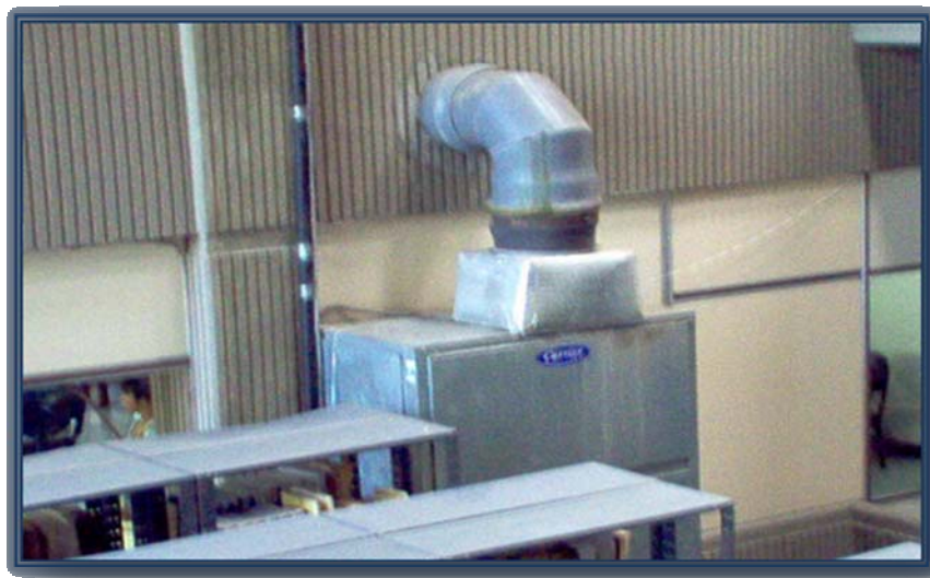
Figura 3.21. Evaporadora de 10 toneladas de refrigeración zona crítica
