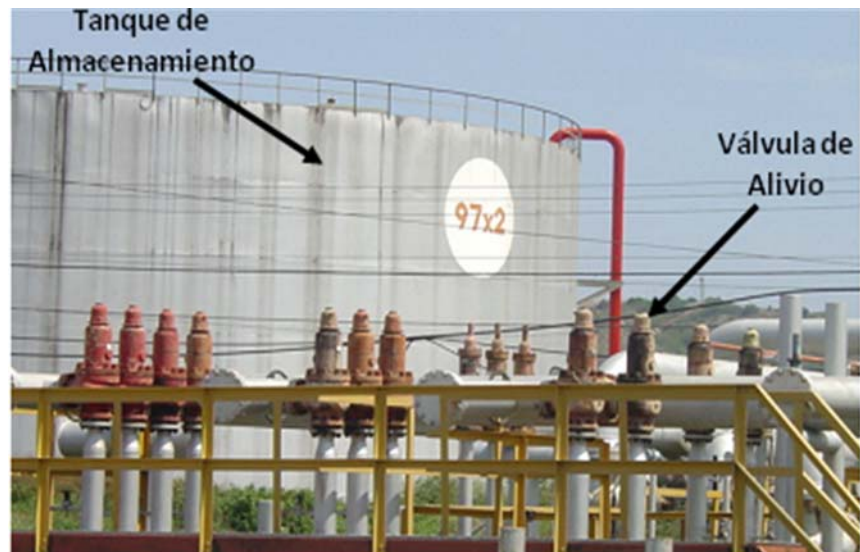
Figura 3.3. Sistema de Alivio ubicado en el Múltiple 2.
