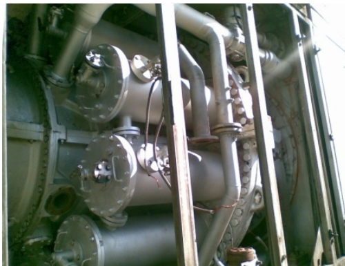
Figura 4.6. Sistema de combustión de las turbinas.
