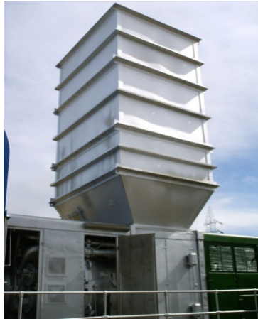
Figura 4.14. Chimenea de gases de escape de la turbina.
