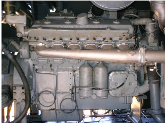
Figura 4.15. Motor Diesel Detroit usado en la central múltiple MS-5000.
