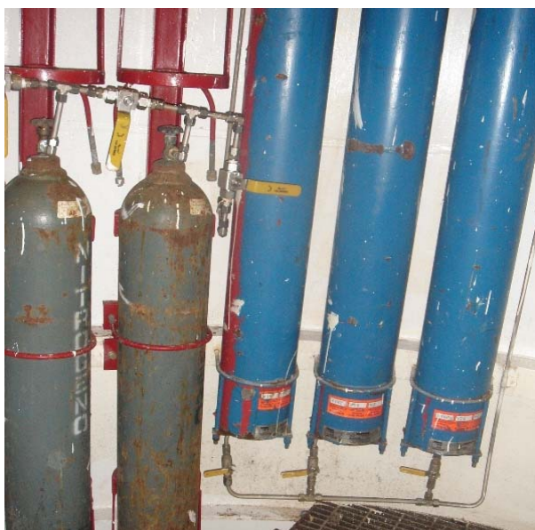
Figura B.3. Conexión entre las bombonas de nitrógeno actuales y los acumuladores de aceite
