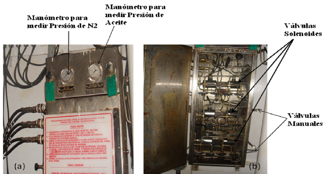
Figura 2.9. Panel de Control de válvulas: (a) Cerrado y (b) Abierto
