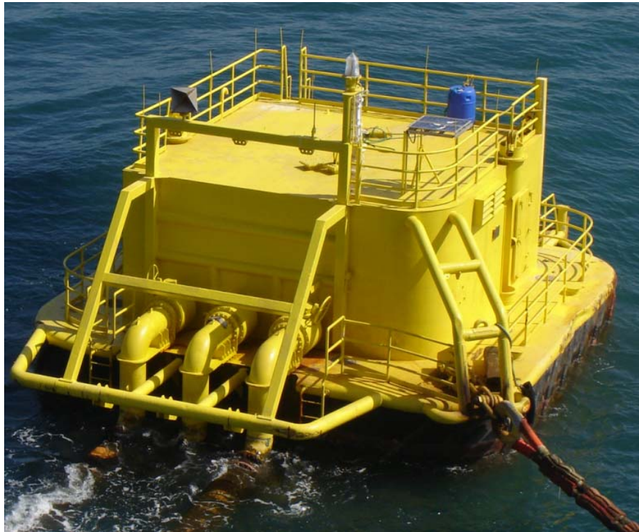
Figura 2.5. Monoboya del Terminal Oriente Jose (TOJ).
