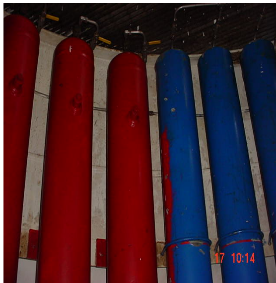
Figura B.2. Acumuladores de aceite y Bombonas de Nitrógeno
