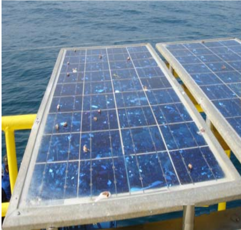
Figura 4.4. Paneles Solares de la Monoboya del TOJ
