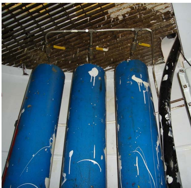
Figura B.4. Tubería superior es conectada a los acumuladores.
