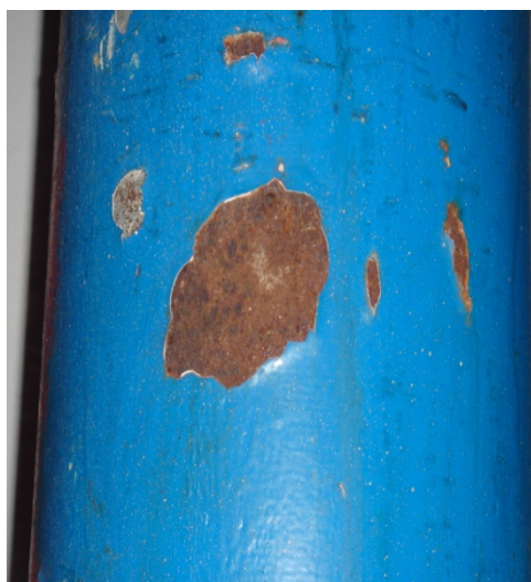
Figura 3.2. Puntos de óxido encontrados en la pared de uno de los acumuladores tipo pistón
