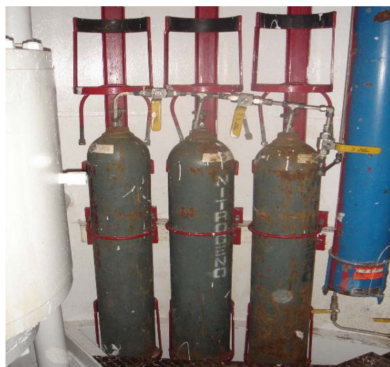
Figura B.6. Bombonas de Nitrogeno pertenecientes al sistema hidráulico de la Monoboya del Terminal Oriente Jose.
