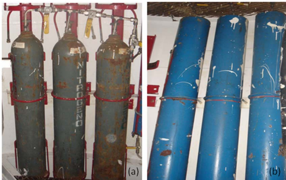
Figura 2.8. (a) Bombonas de nitrógeno y (b) acumuladores de aceite
