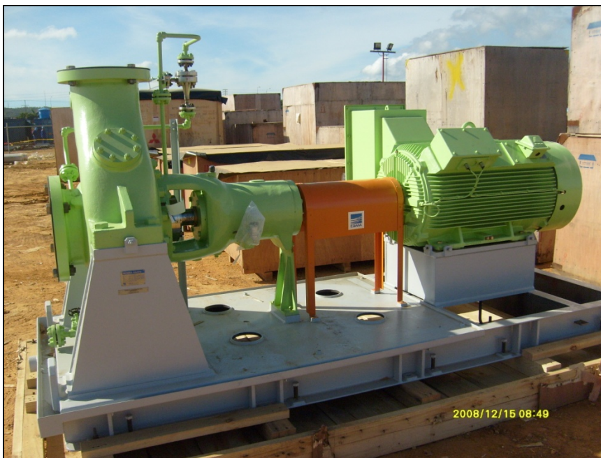
Figura 2.6. Bomba de fondos de la columna de recuperación de la sección de destilación.
