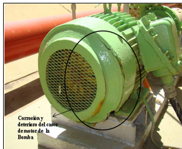
Figura 4.6 Presencia de Corrosión y deterioro del Casco de la bomba P 503 de la Planta en Operación de METOR S.A Fuente: METOR S.A (2009)
