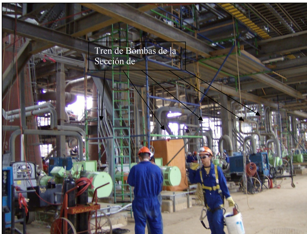
Figura 4.1 Equipos Rotativos de la Sección de Destilación del Proyecto de Expansión METOR S.A
