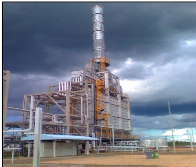
Figura 3.2: Horno H-3001 ubicado en el centro operativo Petrocedeño.
