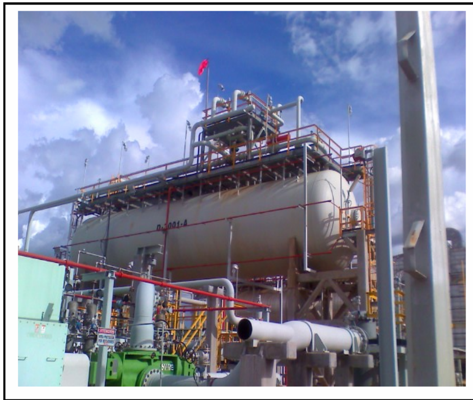
Figura 3.1: Deshidratador Bifásico en Petrocedeño.
