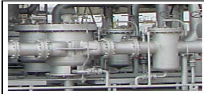
Figura 3.7: Medidor de flujo de desplazamiento positivo.
