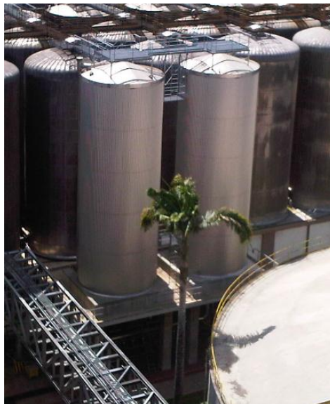
Figura. 2.1 Tanques de agua caliente de cervecería Polar Oriente [5].
