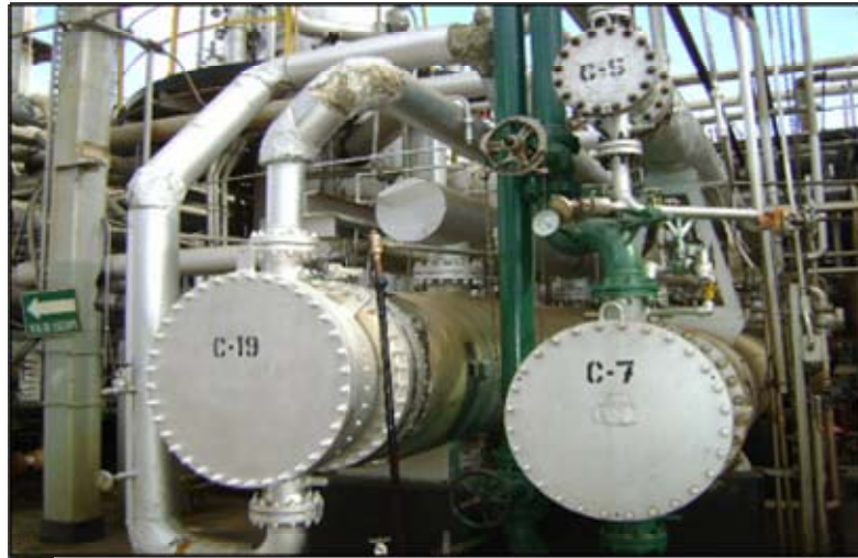
Figura 4.2. Intercambiadores C-19, C-7 y C-5
