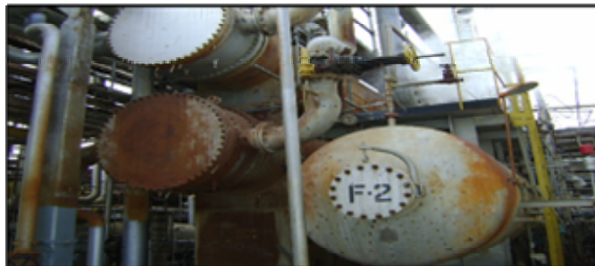
Figura 4.1. Intercambiadores C-10A, C-10B y Tambor F-2
