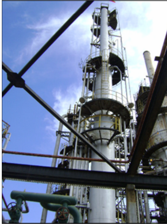
Figura 4.4. Torre E-3 (Absorbedor Primario).
