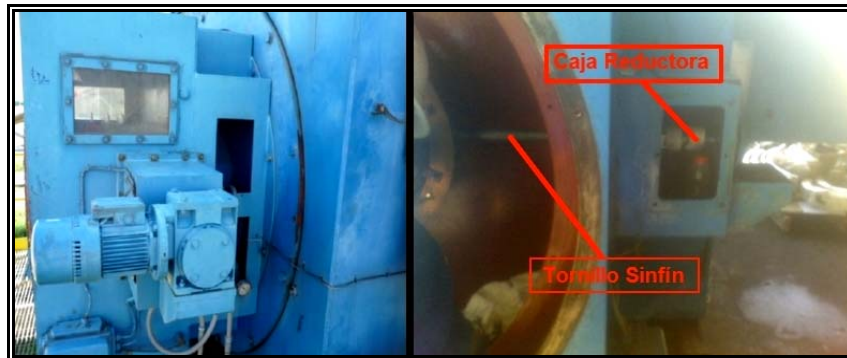
Figura 4. 15. Motor eléctrico y caja reductora del sub-sistema eléctrico de arranque del motor 200-MK-2.
