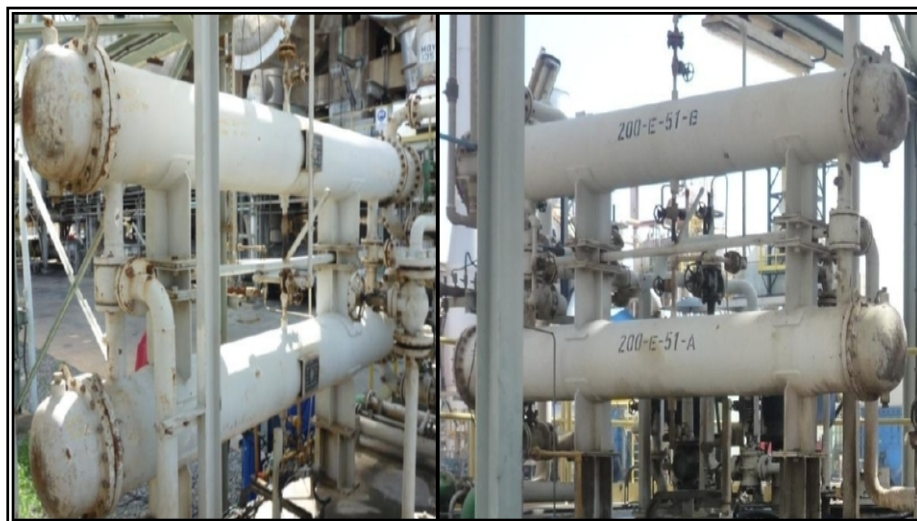
Figura 4. 6. Intercambiadores de Calor del sub-sistema de lubricación.
