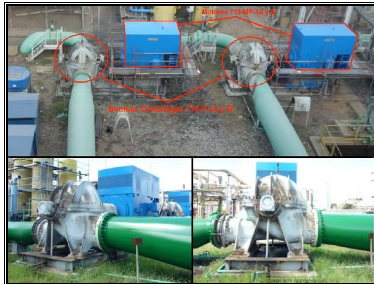
Figura 4. 11. Unidades de bombeo 710-MP-1B y 1C del sub-sistema de enfriamiento del motor 200-MK-2.
