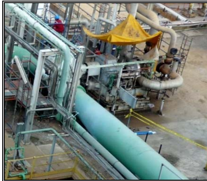
Figura 4. 12. Unidad de bombeo 710-TP-1A del sub-sistema de enfriamiento del motor 200-MK-2.
