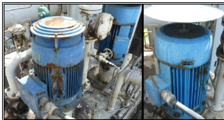
Figura 4. 5. Motores de las unidades de bombeo del sub-sistema de lubricación.
