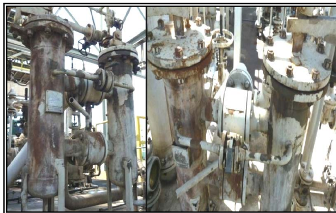
Figura 4. 7. Filtros del sub-sistema de lubricación.
