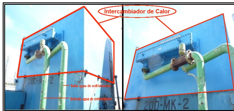
Figura 4. 13. Sub-sistema de enfriamiento del motor 200-MK-2.
