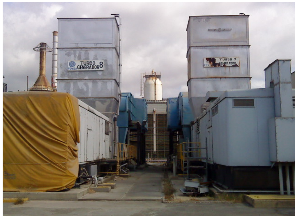
Figura 1.7. Turbogenerador 8 y 7 en Planta Eléctrica
