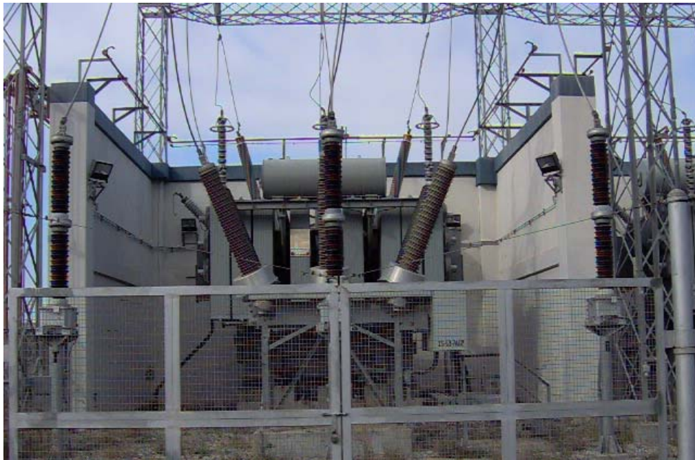
Figura 2.1. Transformador Pauwels Trafo Asia, 554 MVA, 230/34.5 kV
