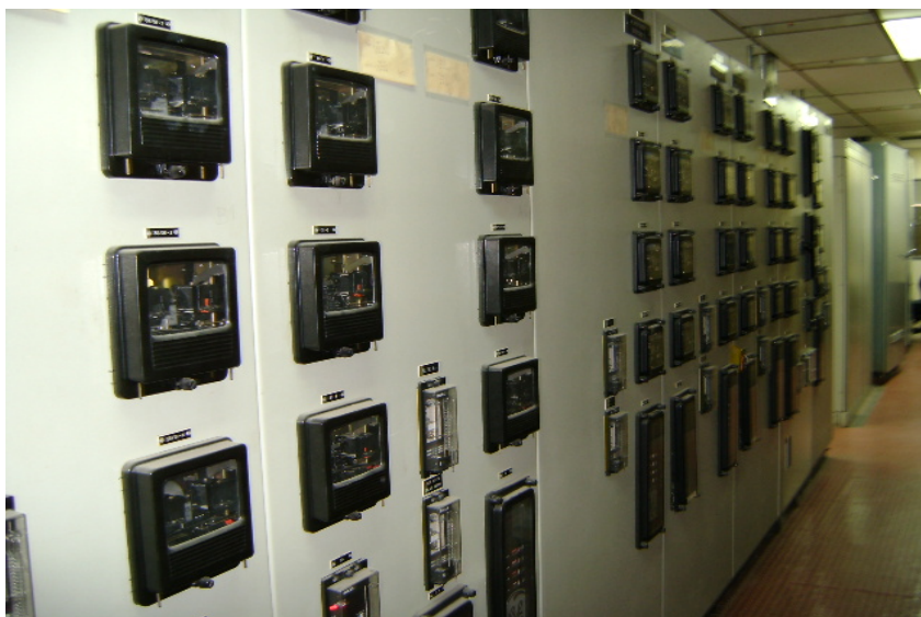
Figura. 2.28. Celdas de los Relés de Los circuitos de Salida instalados en PPE.
