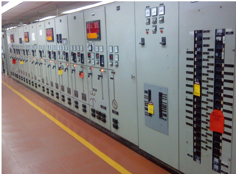
Figura 1.6. Sala de Celdas en Planta Eléctrica 13.8 kV
