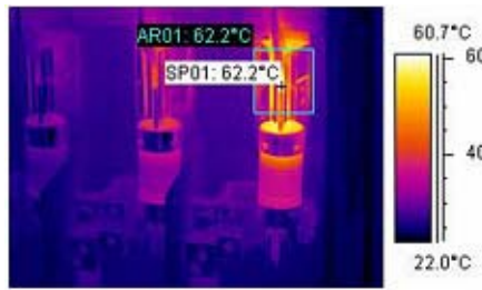
Figura 3.3 Imagen de infrarrojos de una caja de fusibles que muestra la temperatura máxima.
