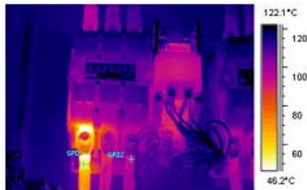
Figura 3.9 Imagen de infrarrojos de equipo eléctrico interior.
