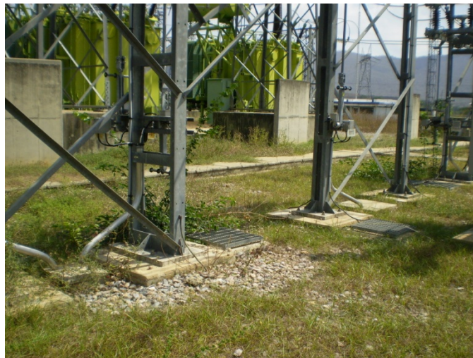
Figura 4.10 Conexión de Tierra de Los Seccionadores asociados a los bushing del autotransformador
