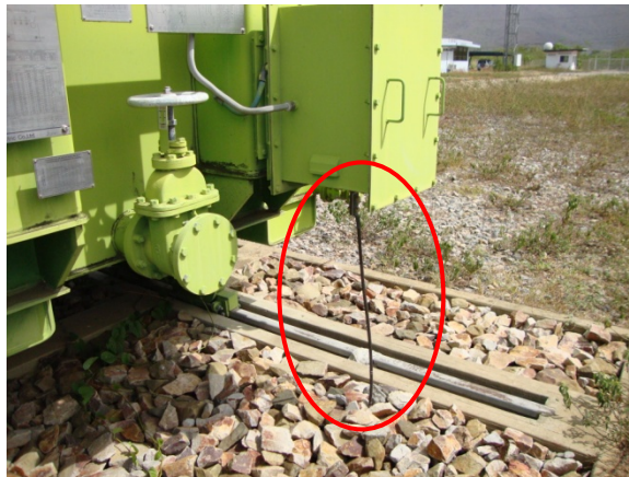
Figura 4.8. Conexión de Tierra de Autotransformador 2 Fuente: Yulineidis Beltrán.
