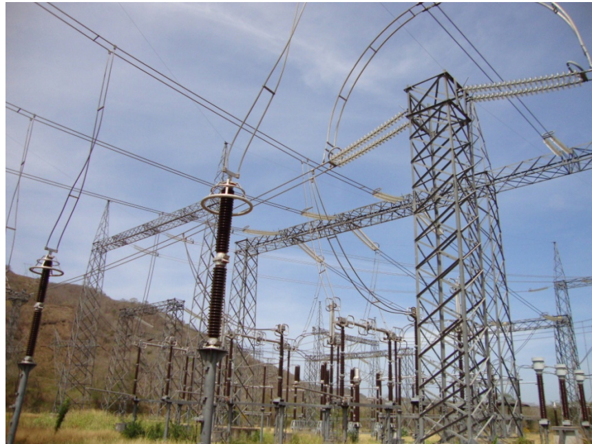
Figura 4.2. Dispositivos de Protección a nivel de Alta tensión. Fuente: Yulineidis Beltrán.
